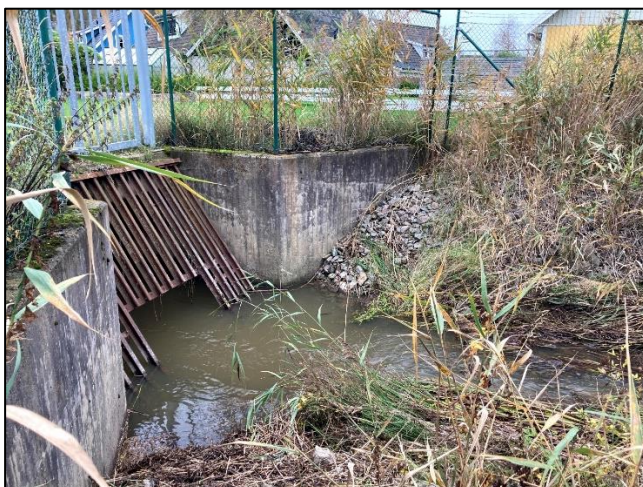
Figur 3-6: Inflöde till kulvert vilken leder dagvattnet ut från området och vidare till recipienten.
