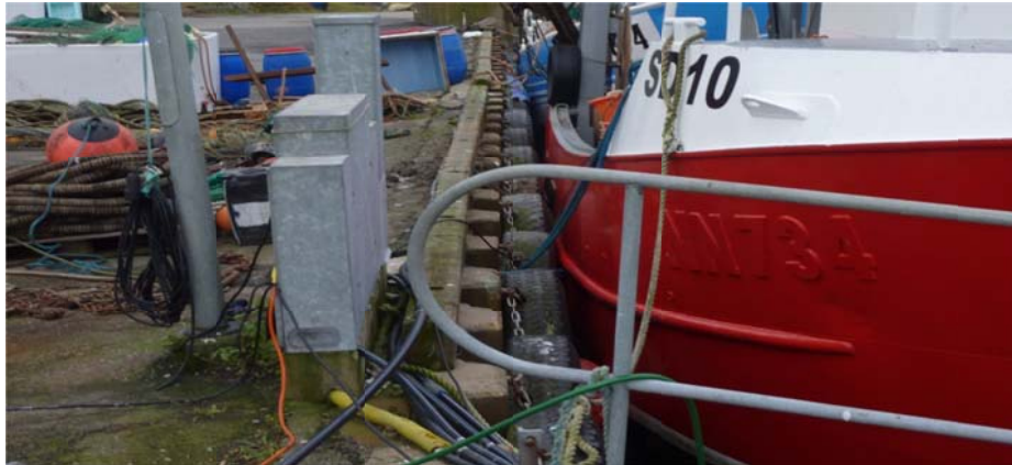
Foto 10. Betongfylld spont med en krönbalk av betong, marken uppvisar sättningar
