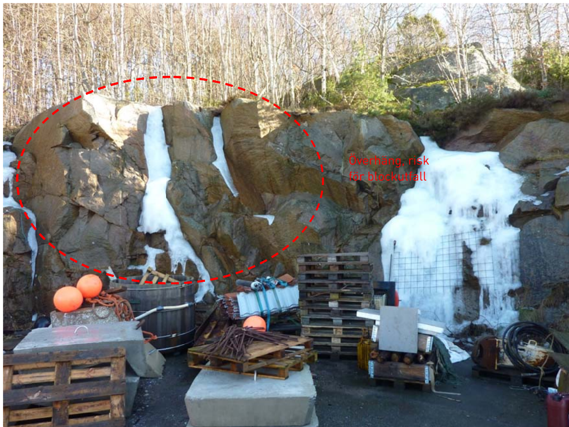
Foto 2. Bergskärningen inom delområde 2 är uppsprucket och det föreligger stor risk för blockutfall.
