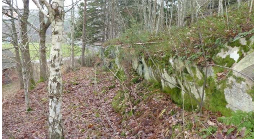
Foto 7. Ondulerande bergsparti som övergår i jordslänt åt norr.
