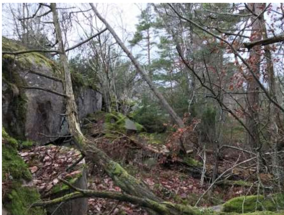
Figur 5. Utfallna block i bergslänten A. Blocken bedöms vara stabila idag.
