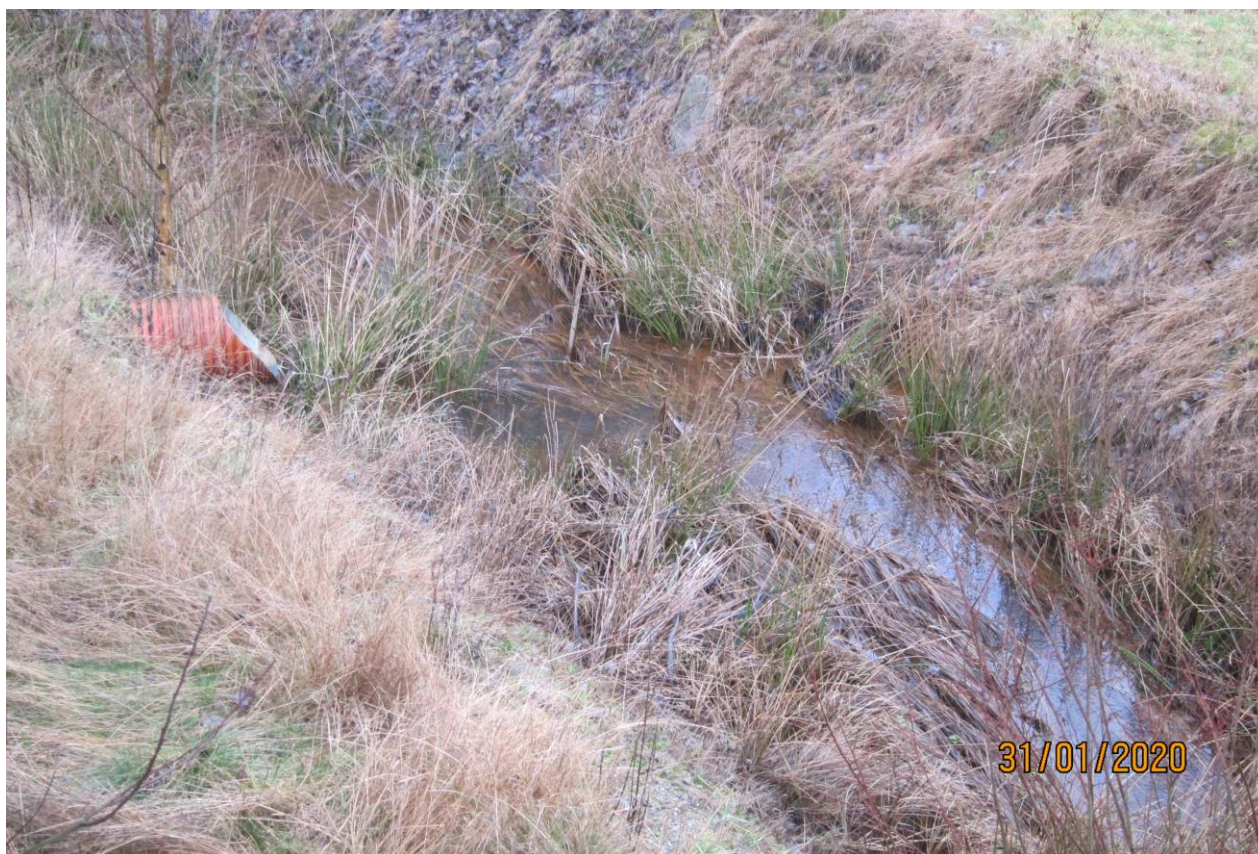
Bild tagen 2020-01-31 vid okulär besiktning på utloppet från dammen tillhörande Sportshopen 1:226. Dammen var fylld till bräddnivå och flödet i diket var nära max nivå.
