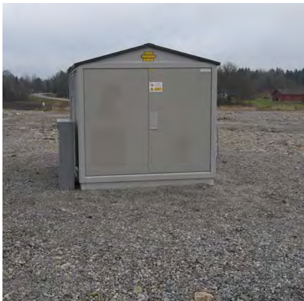
Bild 8. Transformatorstationen ligger centralt i planområdet på den utfyllda marken.
