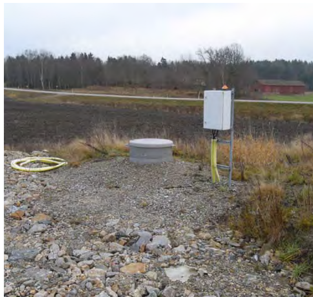
Bild 9. Pumpstationen för avloppet.
