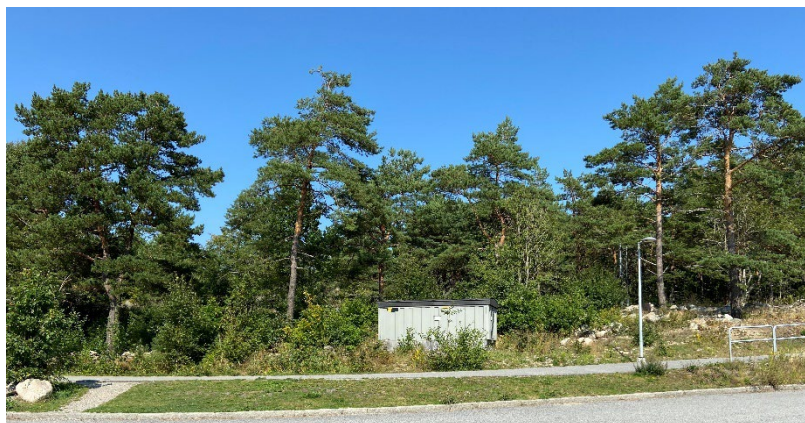
Befintlig transformatorstation mellan gång- och cykelvägen och väg 163.
