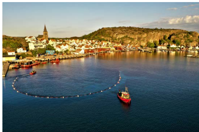
Sjöledningar för vatten och avlopp kommer på plats i Fjällbacka. Fotograf: Henrik Carlsson.
