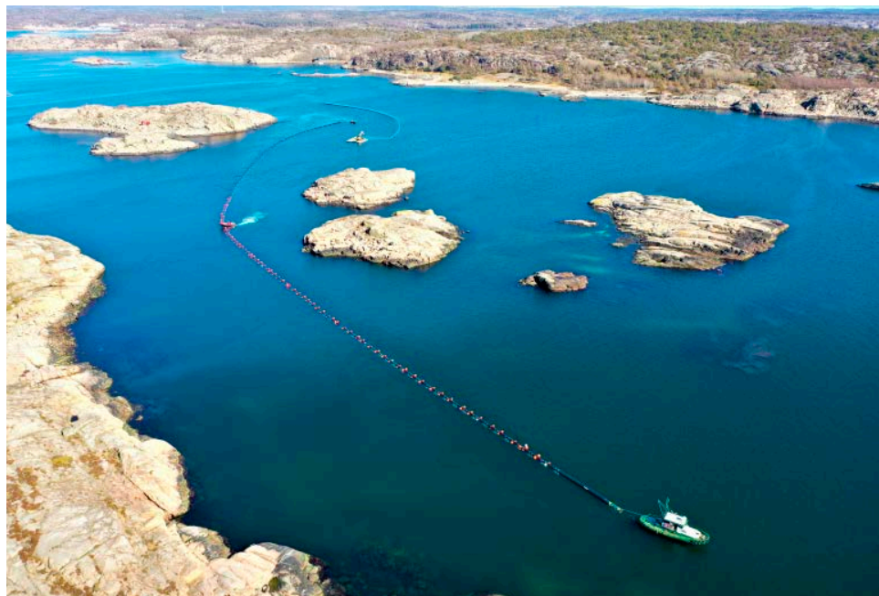
Den nya utloppsledningen flottas ut till platsen där den ska sänkas. Ledningen sträcker sig från Grebbestadkilen till djupområdet utanför Pinnö.
