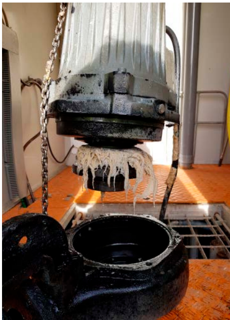
En av avloppsnätets pumpar har lyfts upp för att skräp som tovat ihop sig och stoppat pumpen ska kunna tas bort.
